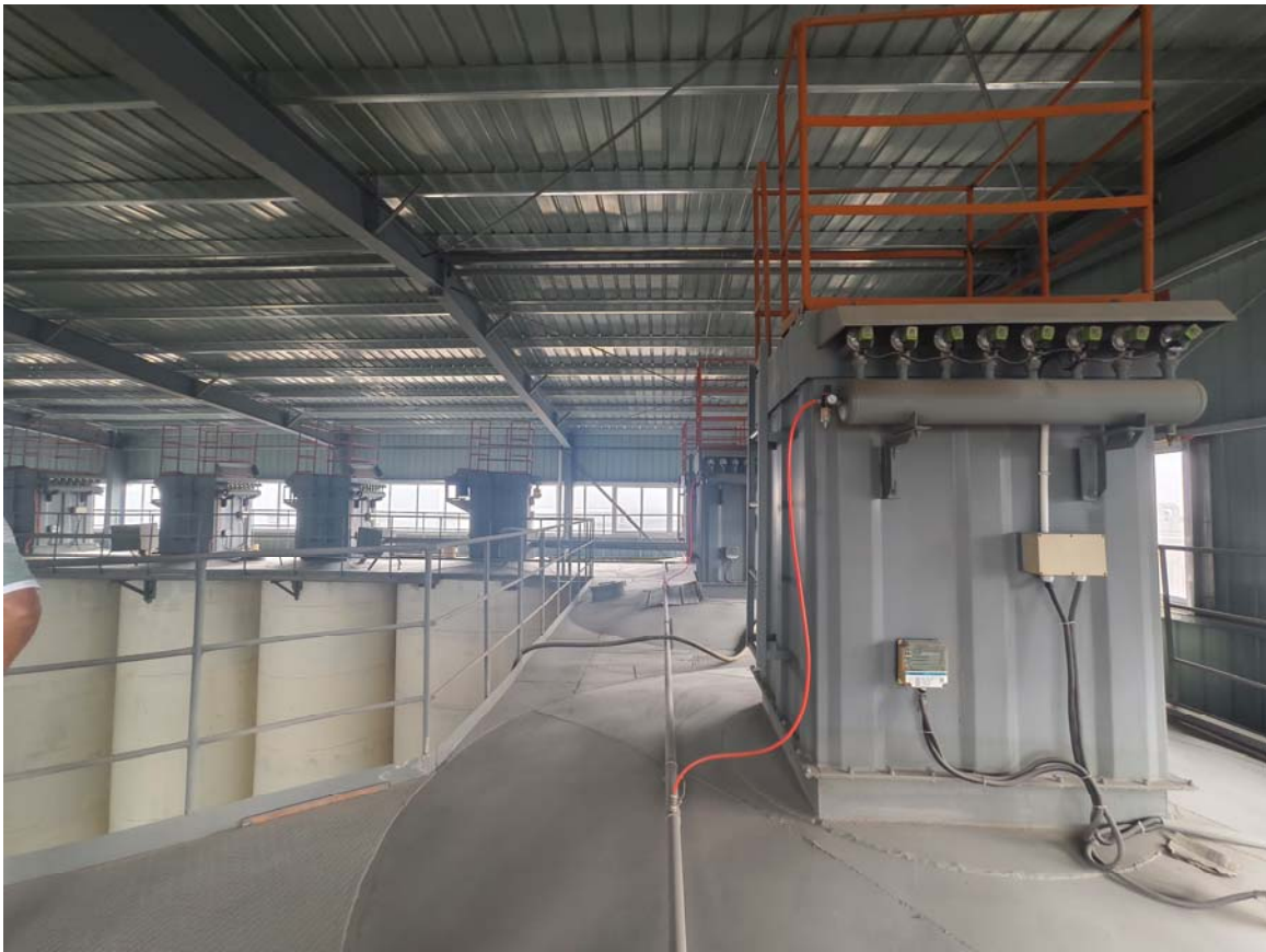
筒仓废气处理设施
