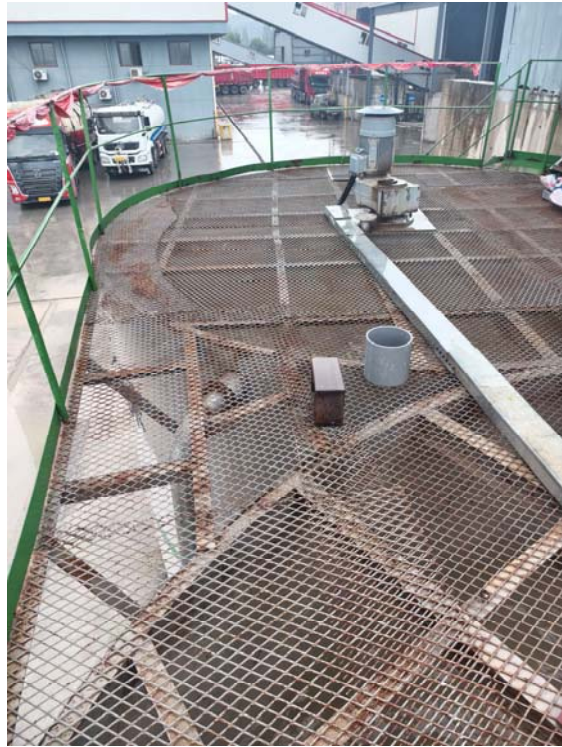
废水处理设施
