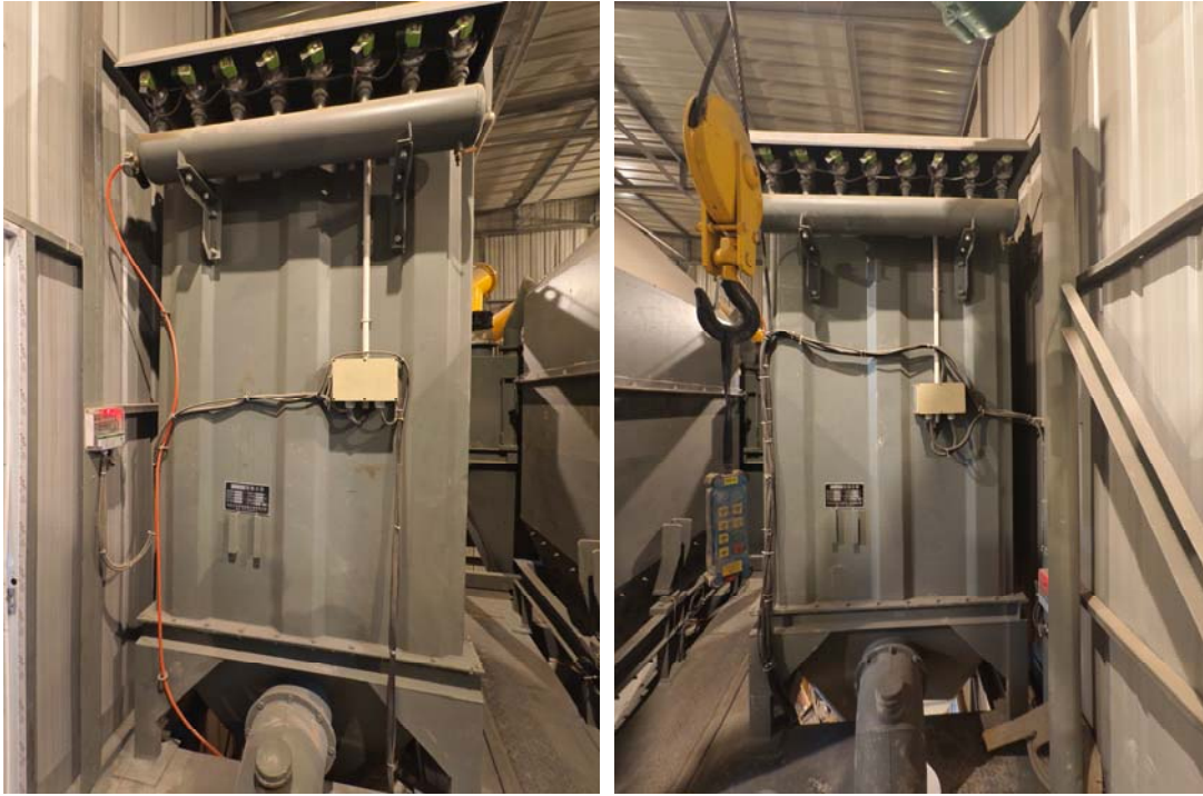
搅拌废气处理设施
