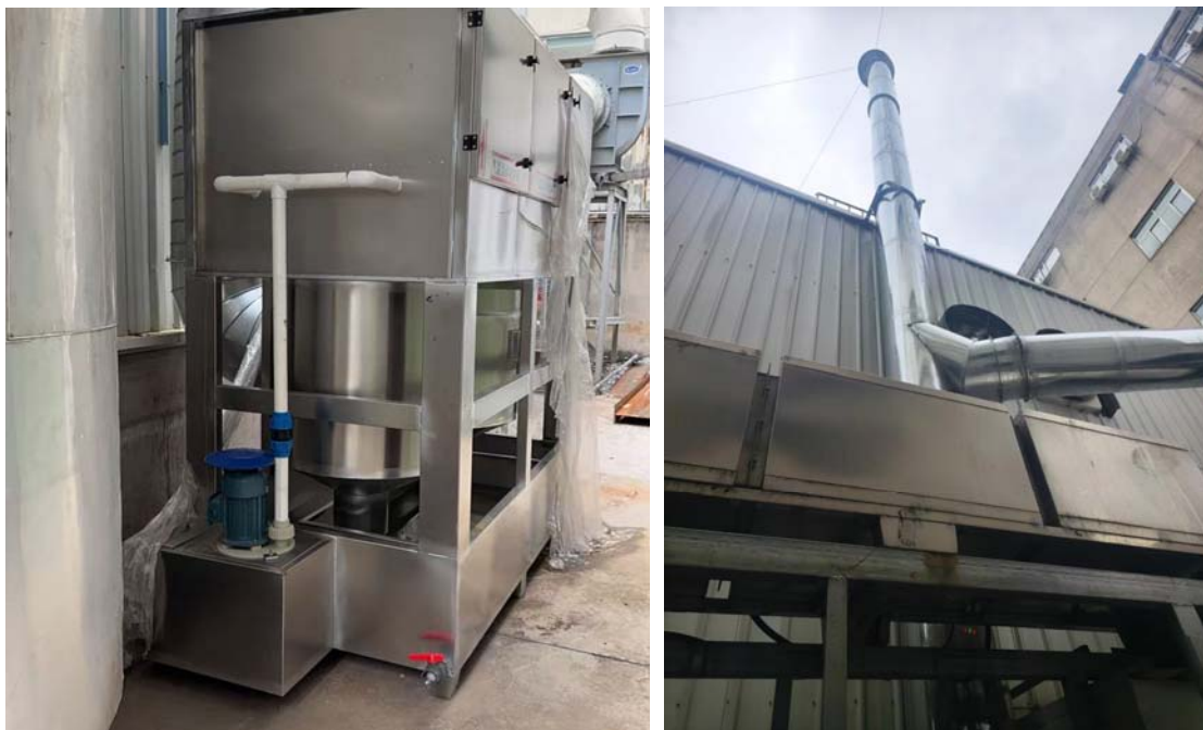
加弹废气处理设施
