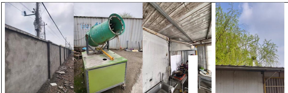
厂界围墙喷雾设施
