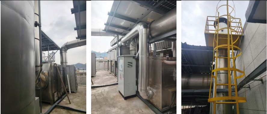
图 3-1 废气处理设施
