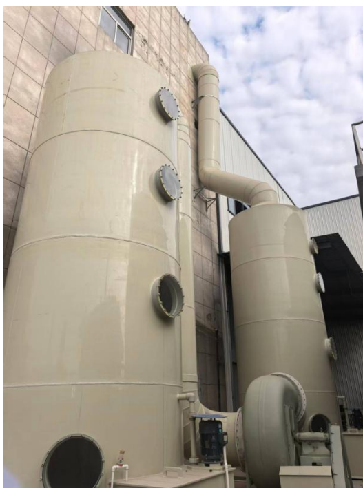
DA001 酸洗酸雾、光亮废气、发黑废气处理设施
